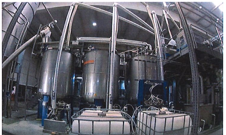
Zona di lavaggio
